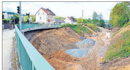
Der (leere) Blick trügt: Mindestens 20 Mitarbeiter dreier Firmen arbeiten ständig am Boxbergknoten, der täglich Fortschritte macht.
