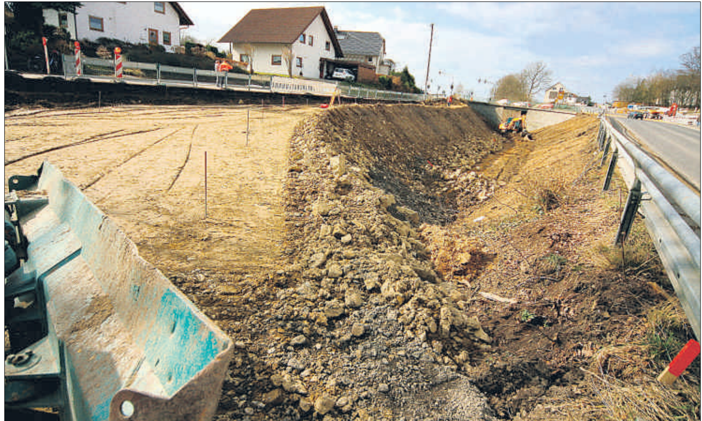
Eine komplett neue Straße nach allen Regeln des Bauhandwerks wird seit knapp einer Woche als provisorische Umfahrung der Großbaustelle „Boxbergkreisel“ errichtet. Schließlich muss der aufgeschüttete Damm auch den Schwerlastverkehr tragen. (Foto: Oehl)
